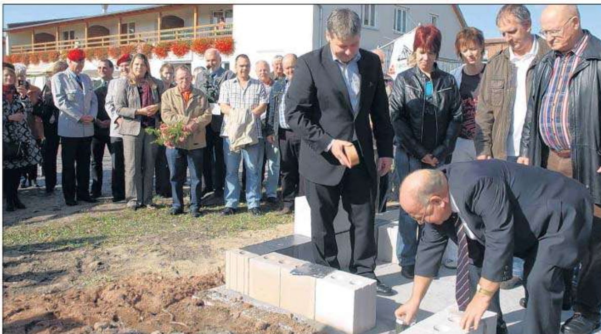
Dr. Günter Bähne und Maik Kleinod (links) versenken die Hülse im Fundament und setzen den fehlenden Mauerstein ein. Zu den Gästen, die dabei zusehen, gehören Sabine Bärmann und Heike Dreßler, Veit Kunzmann und Dr. Ernst Gilbrich. Fotos (2): Anke Schleusner-Reinfeldt
